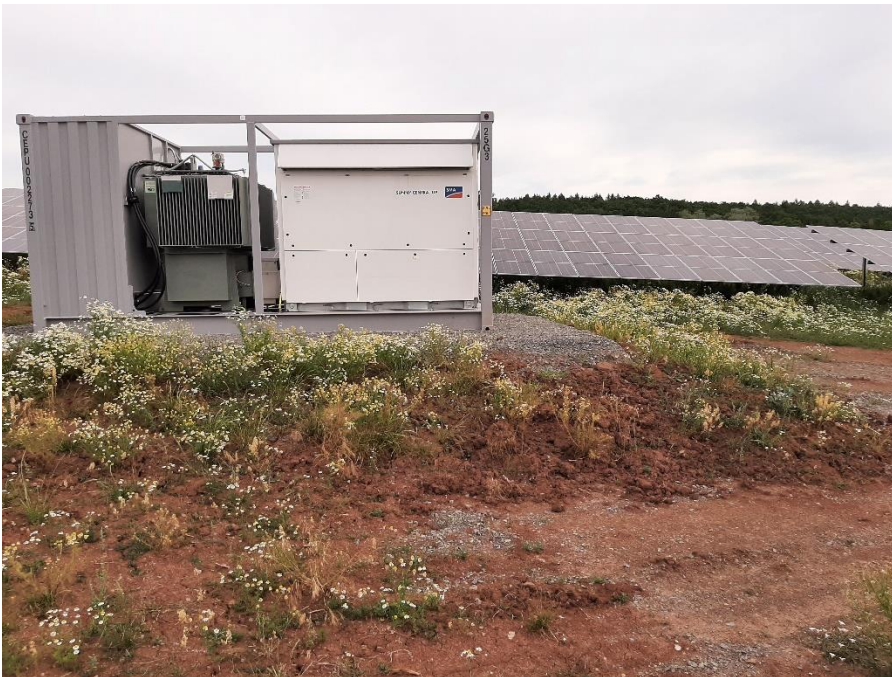
PV-Anlage Bundorf, 27.6.2023: Möglichkeiten zur Anlage von kleinen Steilwänden und Abbruchkanten bieten die Aufschüttungen für die Transformatoren-Häuschen
